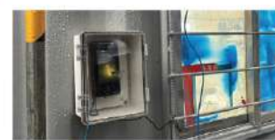
〈POSCO 현장 안전인식기 설치〉
