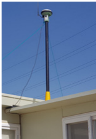
현장 사무실 외부에 설치된 GNSS 기준국
